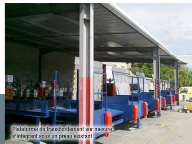
Plateforme extérieure pour quatre postes de chargement
